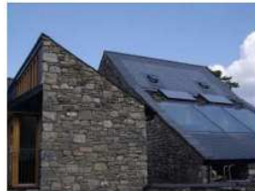
Esempio di pannelli fotovoltaici e solari termici correttamente inseriti nella composizione della copertura e del fabbricato.
